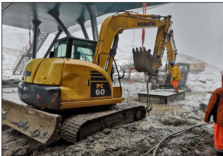
Figura 3.10 – Perda de resistência do solo superficial congelado, durante a passagem de máquinas na obra
