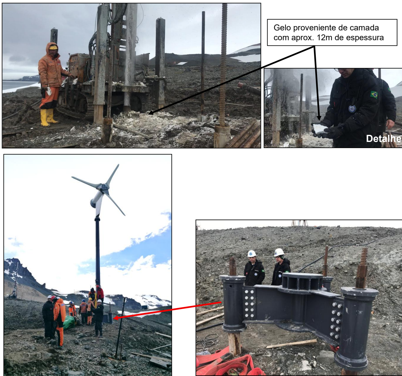
Figura 4.18 – Presença de camada de gelo no subsolo (fundações dos aerogeradores)
