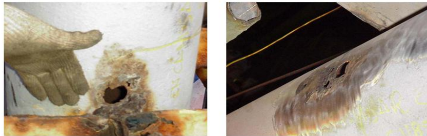
Figura 2.1 – Dano por corrosão em tubulação de água
