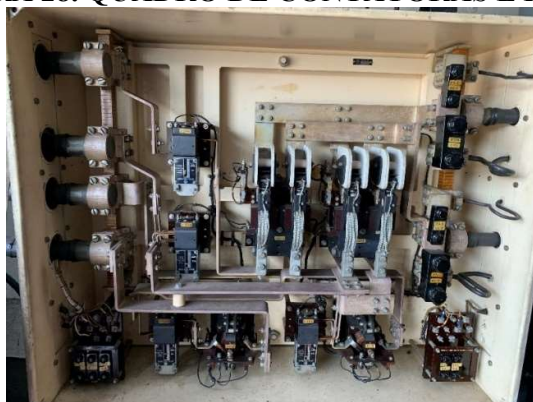
FIGURA 28. QUADRO DE CONTADORAS E RELÉS.
